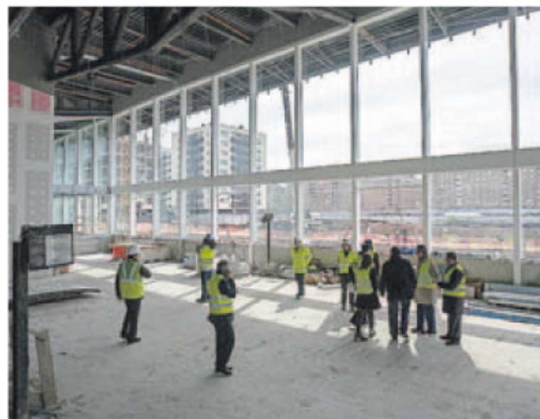
Visita a la sección sur de la estación, aún en obras. :: DÍAZ URIEL
